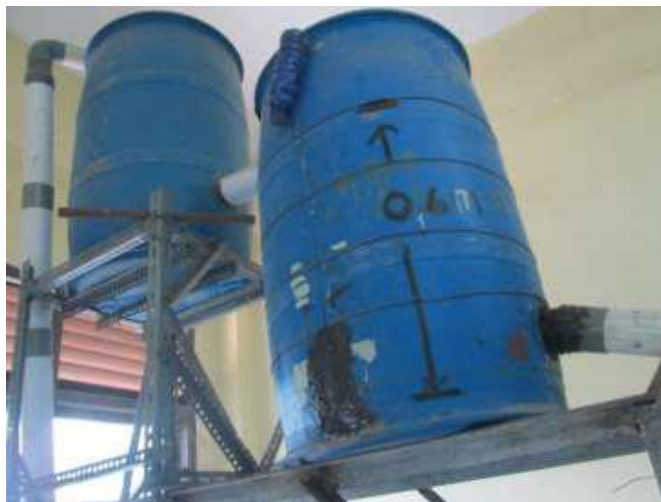
Gambar 10. Bak penampung air.
